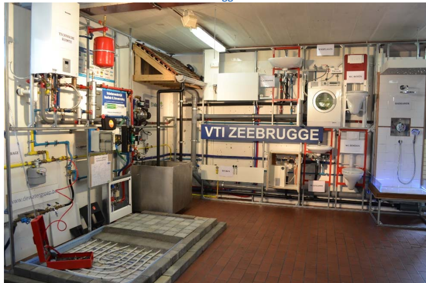
Installatie VTI Zeebrugge – laureaat BSO
